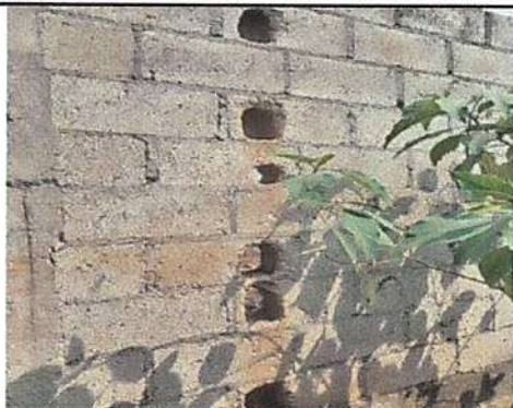
Foto 1: Se necesita reparar el muro perimetral ya que personas ajenas lo han dañado
